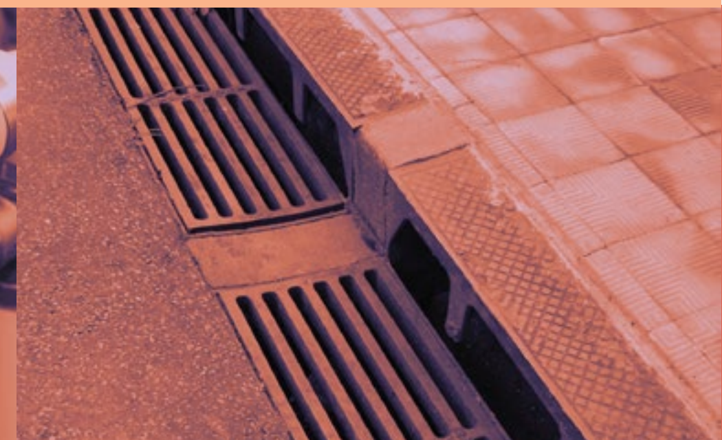
Rede de galeria de águas pluviais e bocas de lobo
