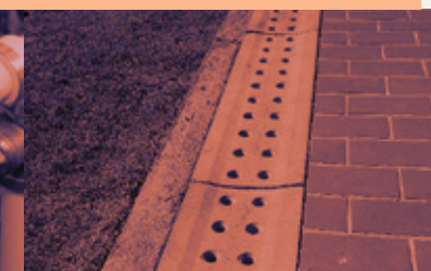
Rede de galeria de águas pluviais e bocas de lobo
